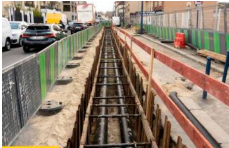
Figure 7: Exemple d'un chantier sur le réseau de chaleur enterré. Source : Étude d'impact, p. 140.
